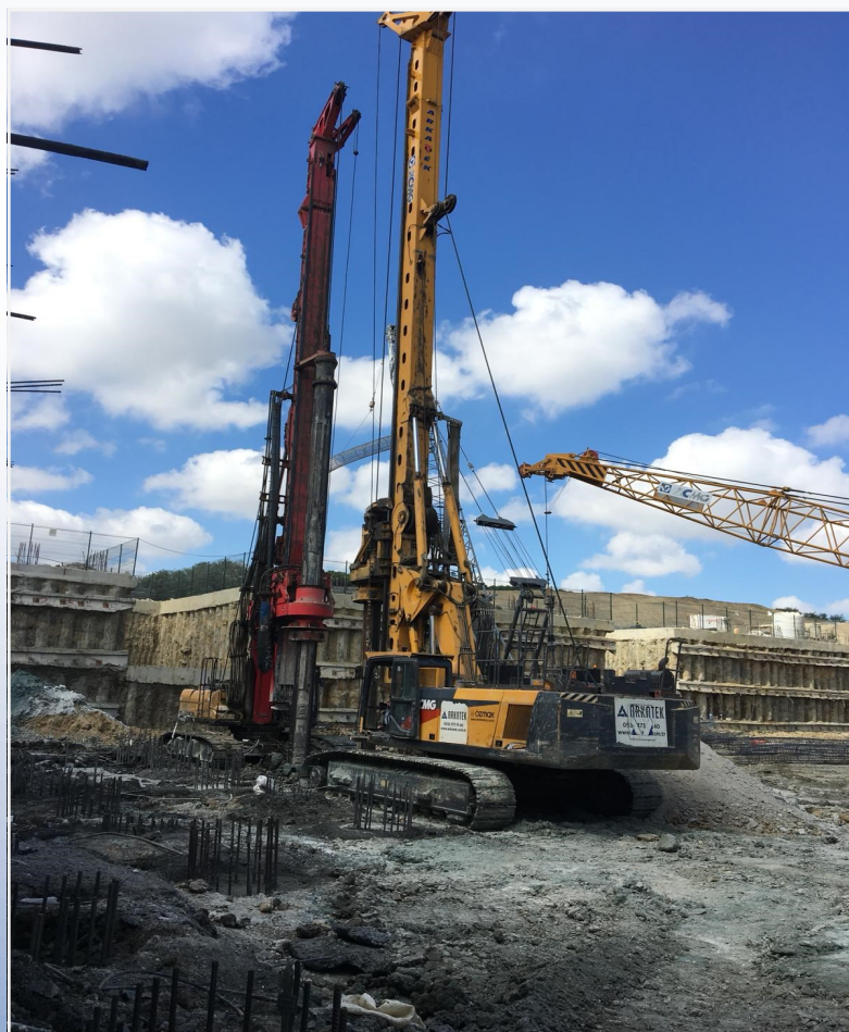
İ.V.V. ТВЕРДЫЕ ОТХОДЫ И ЕНЕРЖИ ПРОИЗВОДСТВЕННЫЕ МОЩНОСТИ
